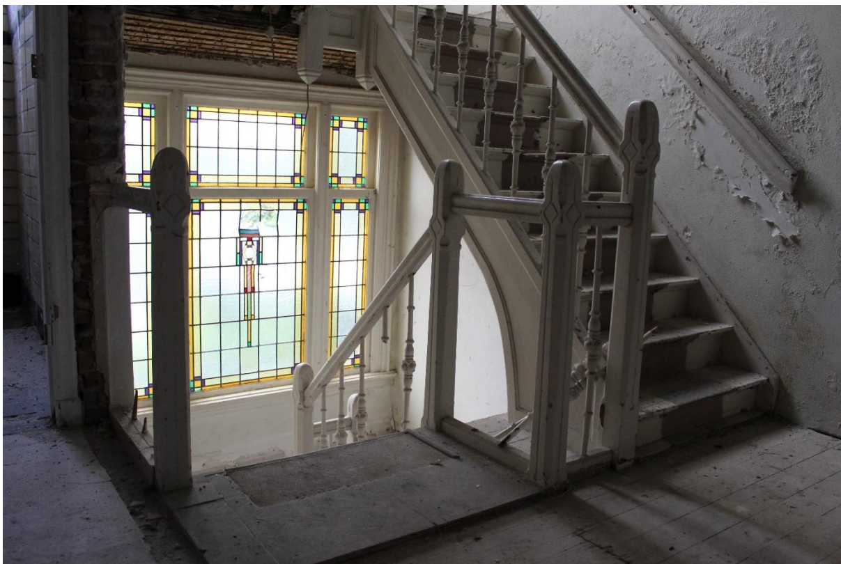
Figuur 19 Het trappenhuis op de verdieping, met weggebroken en gehavende balustrades.
