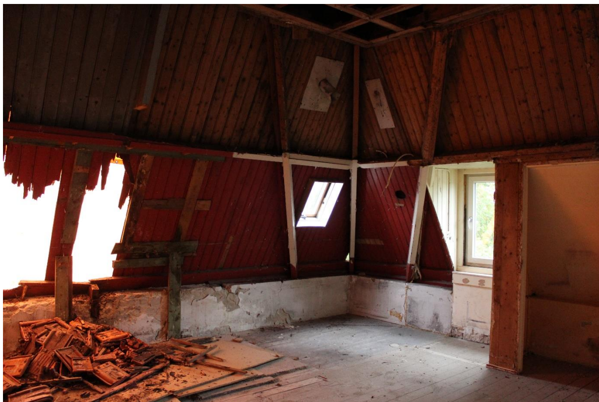
Figuur 23 Eén van de zolderkamers. Door het gat in het dak hebben de elementen vrij spel.
