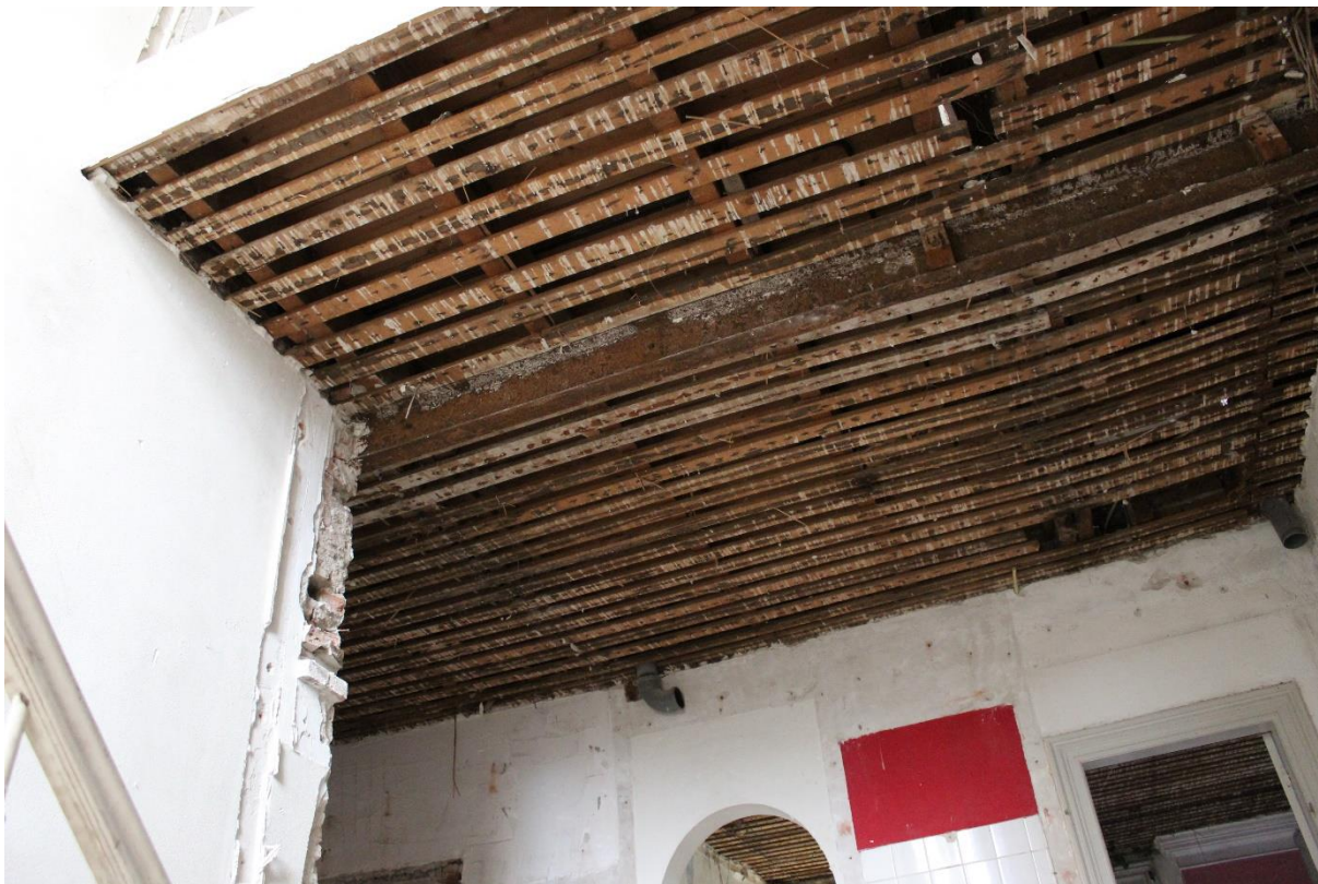
Figuur 20 Het huidige plafon boven de overloop. Links is nog aanzet van een verwijderde console zichtbaar.
