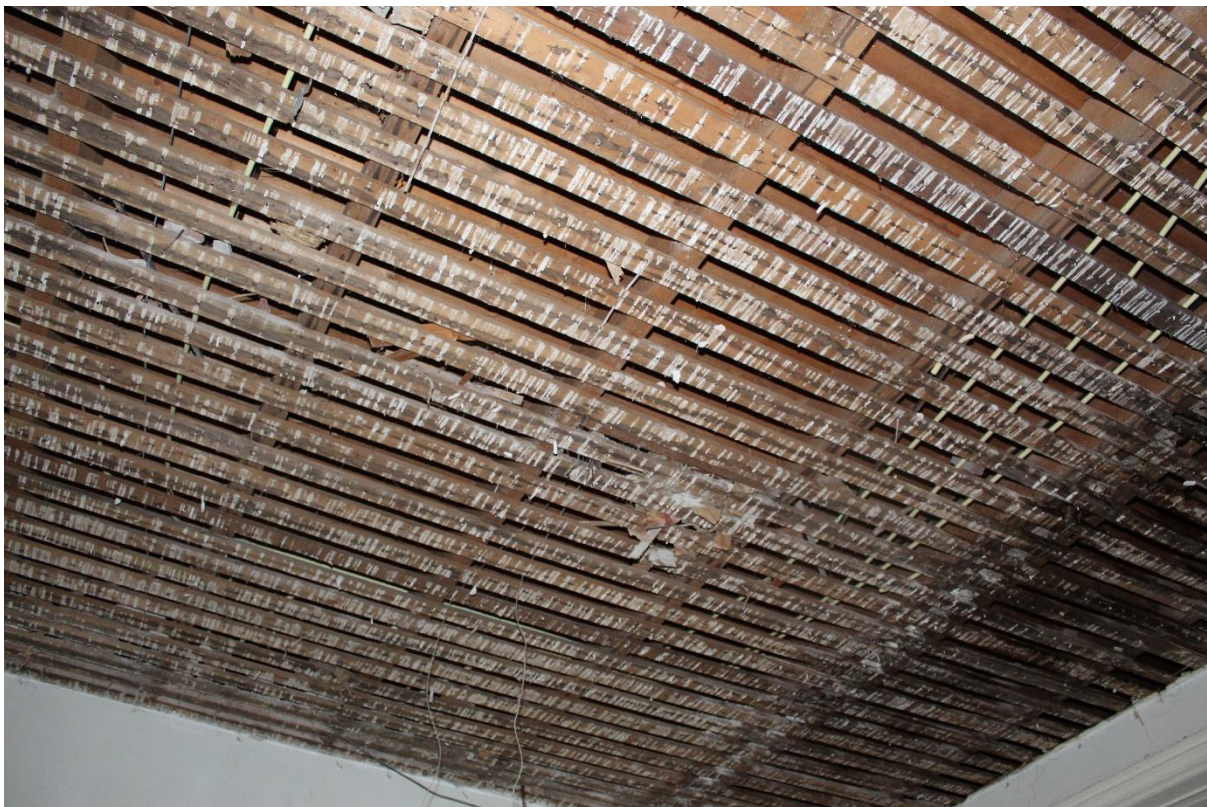
Figuur 18 Het latwerk waar één van de stucplafonds. Deze situatie is exemplarisch.
