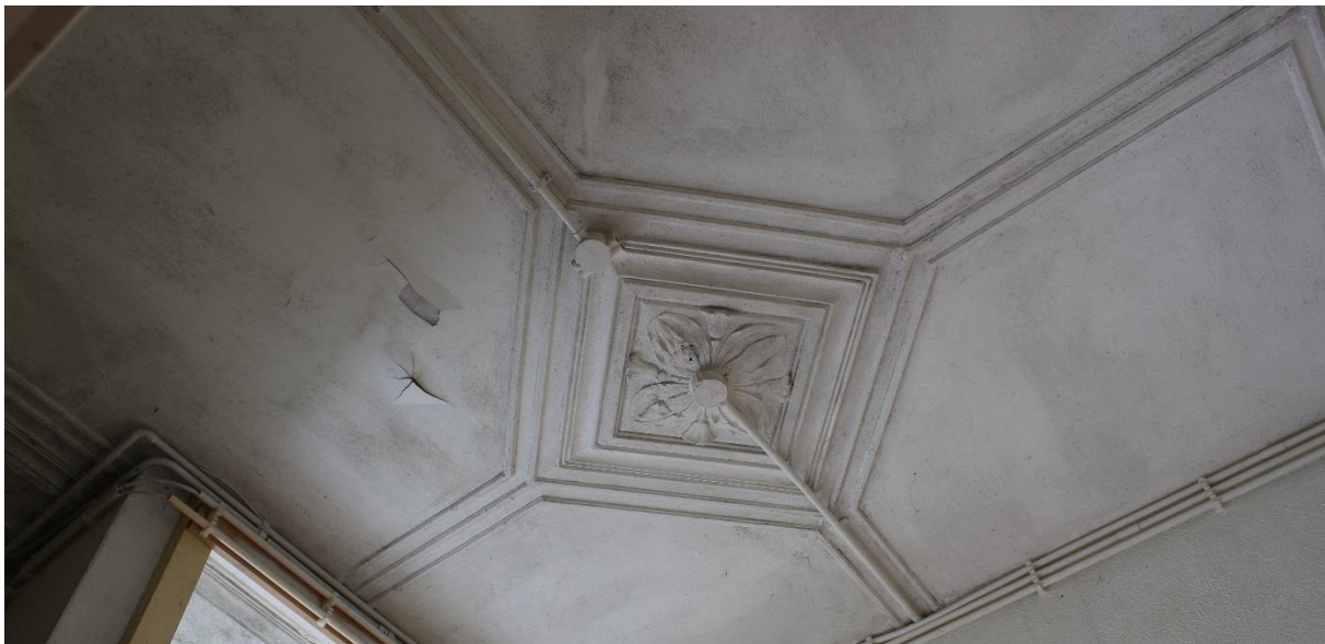
Figuur 17: Het plafond in de verkeersruimte bij de trap.
