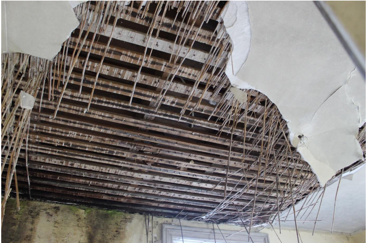
Figuur 29: De plafondconstructie die door verval in het zicht is gekomen.
