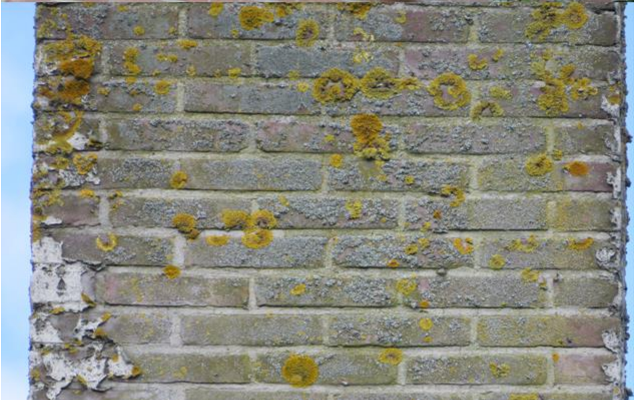
Geen ruimte in ventilatiegaten. Geen open stootvoegen in de schoorsteen.
