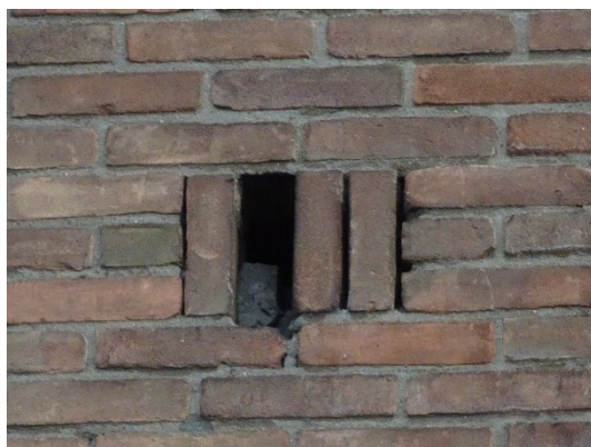
Figuur 3.4 Grote opening bij ventilatievoegen aan Juliana van Stolberglaan 96
