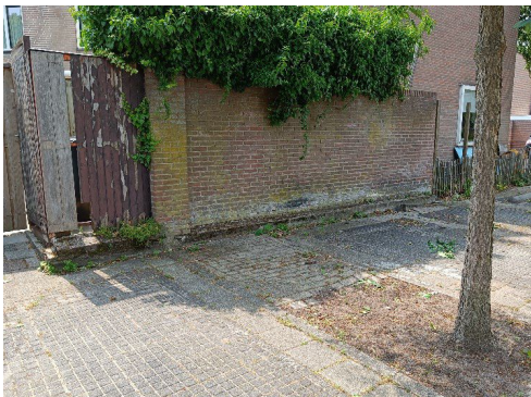
Knelpunt: verzakt maaiveld t.o.v. fundering woningen
